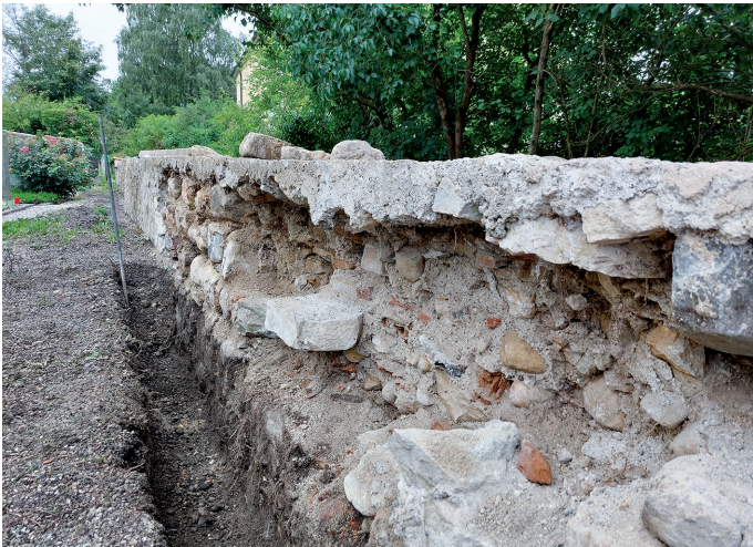
Schwere Schäden an der Friedhofsmauer
