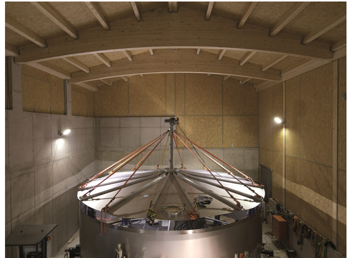
Der erste der beiden neuen Trinkwasserbehälter wird gerade im Inneren des Gebäudes errichtet
