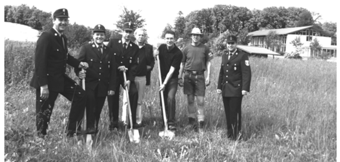
v.li. 2. Vorstand Sepp Bauer, 1. Vorstand Wolfgang Ull, Kommandant Robert Staber, Planer Claus Lerche, Bürgermeister Georg Huber, Bauunternehmer Robert Gsinn und 2. Kommandant Toni Stuffer
